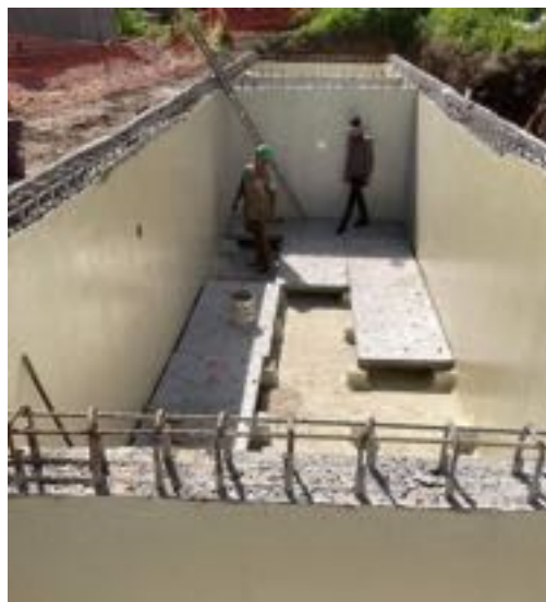
Non ce n'est ni une piscine... ni une cave à vin Mais la fosse-séptique de Te Vai-ete 'api !!!
